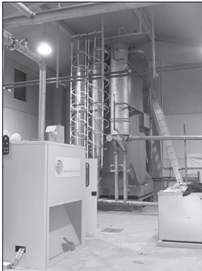
Qui sopra: il Gassificatore di legna e, in primo piano, uno dei generatori di corrente. In alto l’esterno della centrale.
